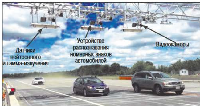
Элементы системы радиационного контроля «Рейн», установленные над проезжей частью
